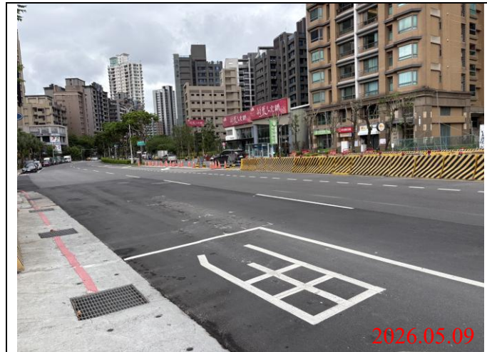
巡查日期地點：115.05.09/ Y22車站 照片說明：路面龜裂狀況
