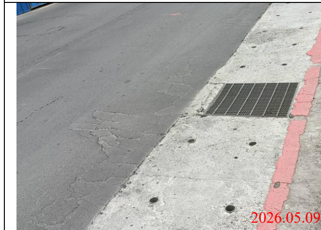
巡查日期地點：115.05.09/ Y22車站 照片說明：路面龜裂狀況
