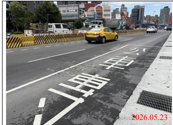
巡查日期地點：115.05.23/ Y22車站 照片說明：路面龜裂狀況
