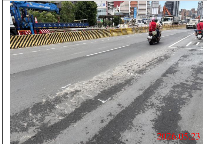
巡查日期地點：115.05.23/ Y22車站 照片說明：路面龜裂狀況
