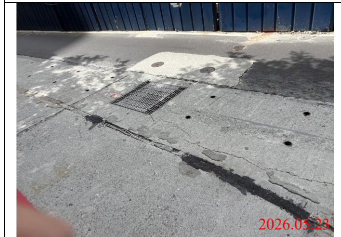
巡查日期地點：115.05.23/ Y23車站 照片說明：路面龜裂狀況
