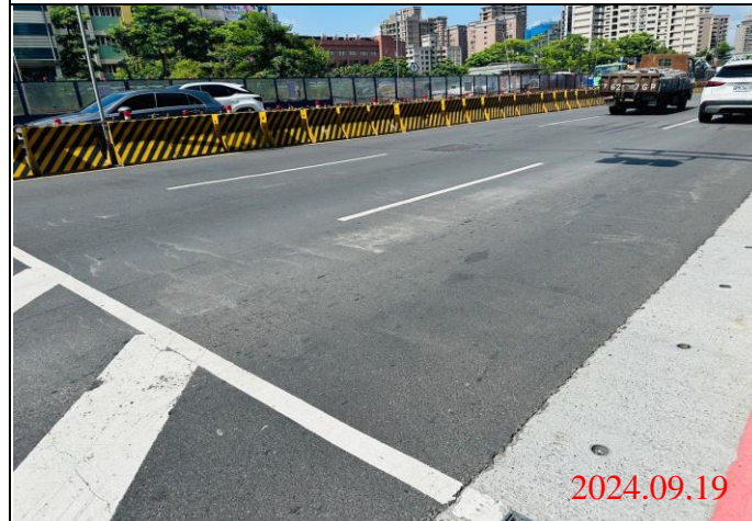
巡查日期地點：113.09.19/ Y23車站 照片說明：道路龜裂
