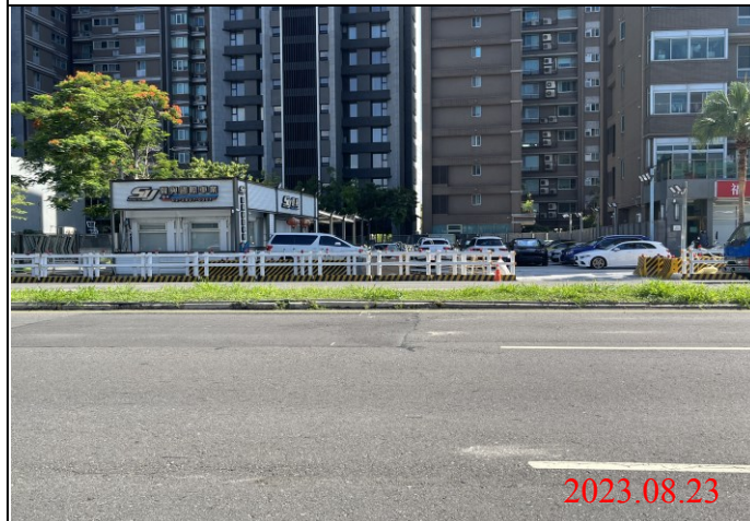
巡查日期地點：112.08.23/ Y23車站 照片說明：路面龜裂狀況
