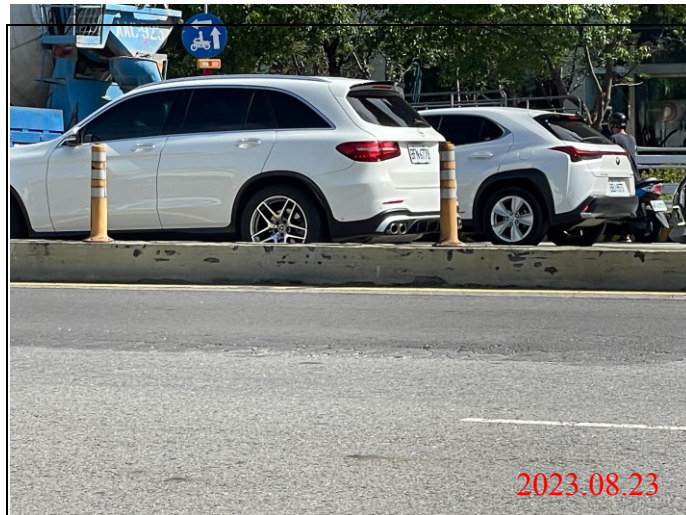
巡查日期地點：112.08.23/ Y23車站 照片說明：路面龜裂狀況
