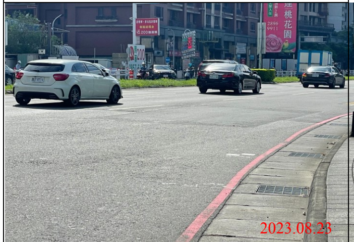
巡查日期地點：112.08.23/ Y23車站 照片說明：路面龜裂狀況
