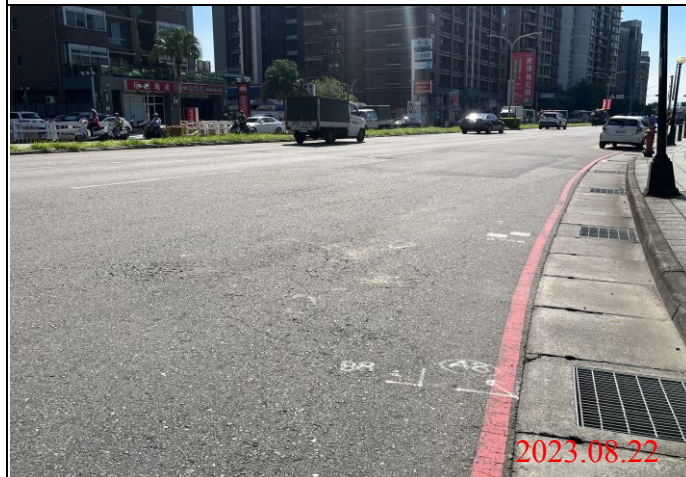
巡查日期地點：112.08.22/ Y23車站 照片說明：路面龜裂狀況
