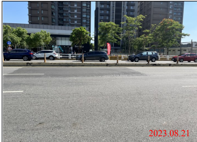
巡查日期地點：112.08.21/ Y23車站 照片說明：路面龜裂狀況
