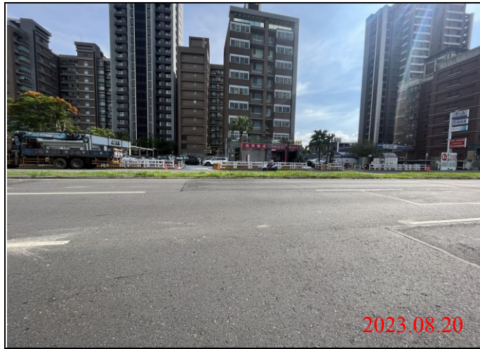
巡查日期地點：112.08.20/ Y23車站 照片說明：路面龜裂狀況
