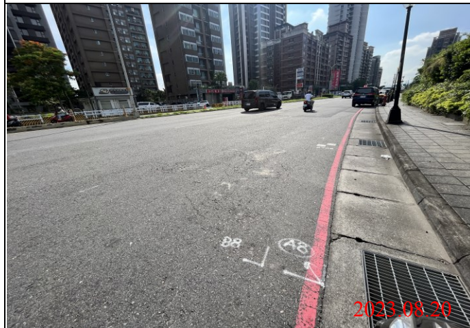
巡查日期地點：112.08.20/ Y23車站 照片說明：路面龜裂狀況
