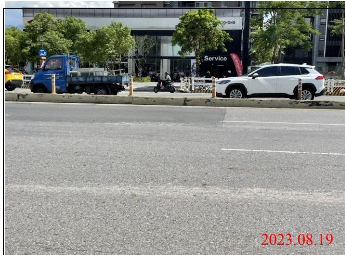
巡查日期地點：112.08.19/ Y23車站 照片說明：路面龜裂狀況
