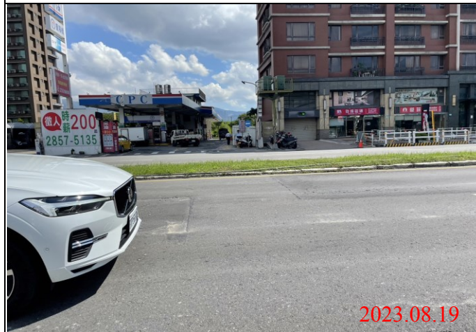
巡查日期地點：112.08.19/ Y23車站 照片說明：路面龜裂狀況
