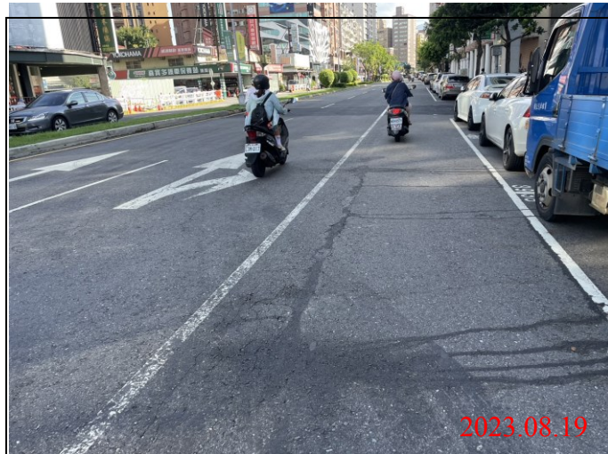
巡查日期地點：112.08.19/ Y21車站 照片說明：路面龜裂狀況
