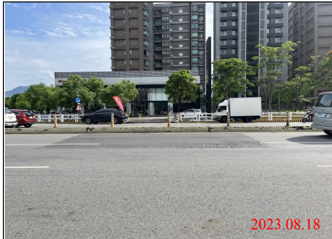
巡查日期地點：112.08.18/ Y23車站 照片說明：路面龜裂狀況
