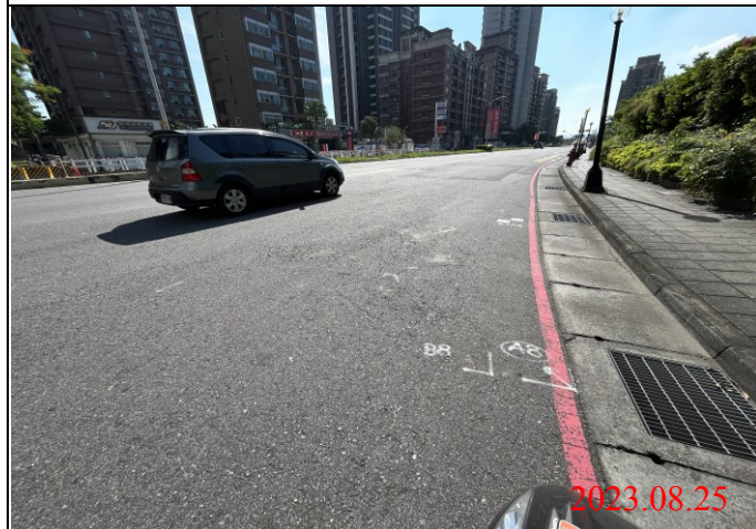
巡查日期地點：112.08.25/ Y23車站 照片說明：路面龜裂狀況
