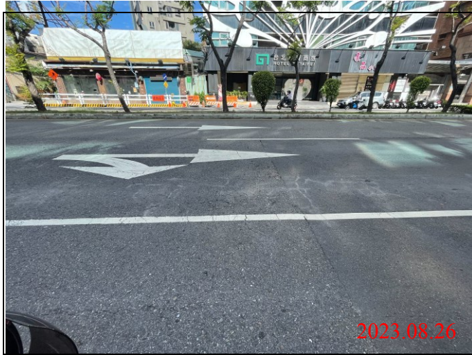
巡查日期地點：112.08.26/ Y21車站 照片說明：路面龜裂狀況
