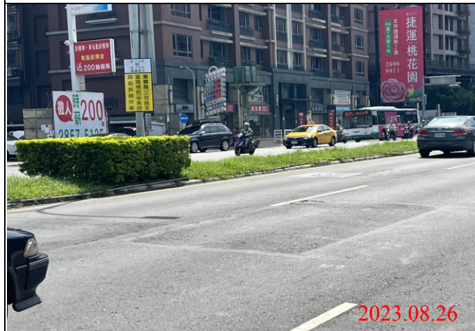
巡查日期地點：112.08.26/ Y23車站 照片說明：路面龜裂狀況
