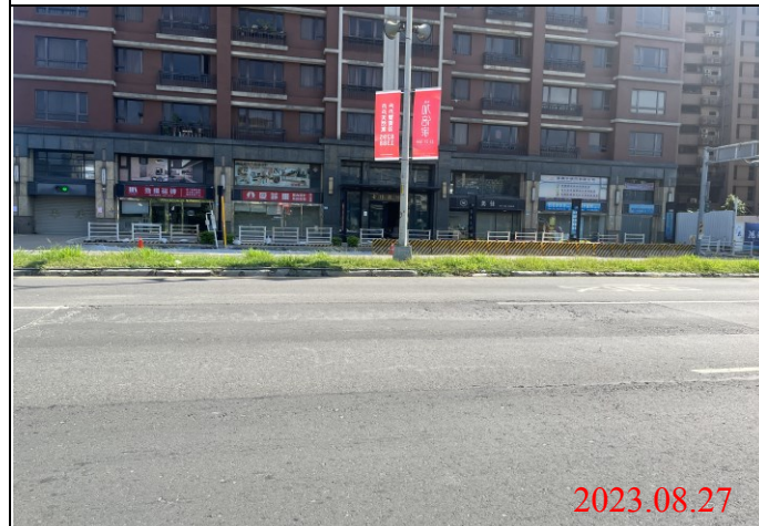
巡查日期地點：112.08.27/ Y23車站 照片說明：路面龜裂狀況
