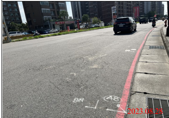
巡查日期地點：112.08.28/ Y23車站 照片說明：路面龜裂狀況
