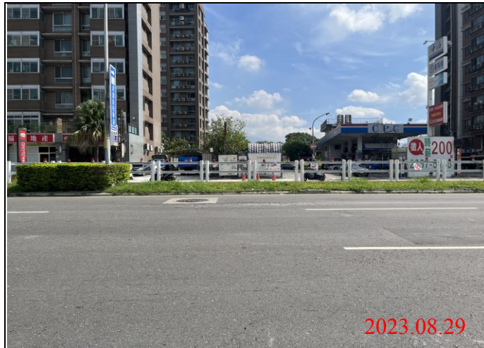
巡查日期地點：112.08.29/ Y23車站 照片說明：路面龜裂狀況
