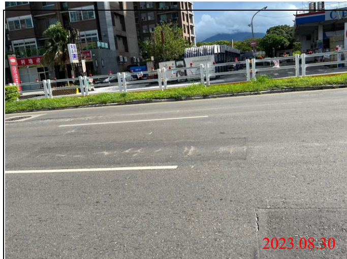
巡查日期地點：112.08.30/ Y23車站 照片說明：路面龜裂狀況
