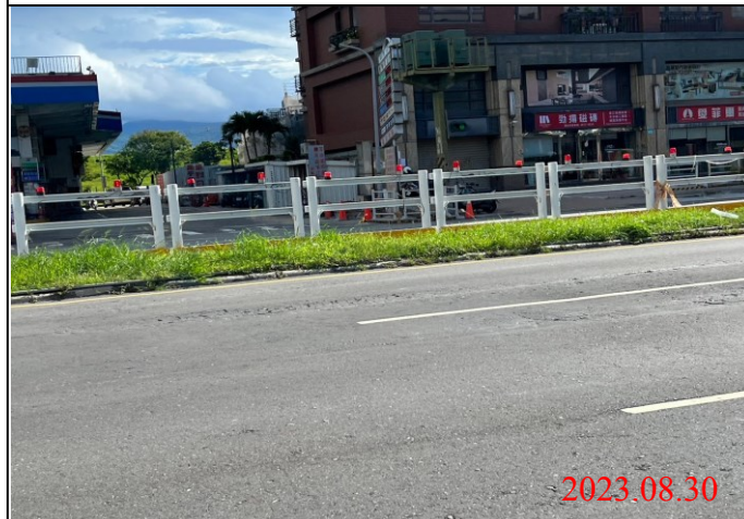
巡查日期地點：112.08.30/ Y23車站 照片說明：路面龜裂狀況
