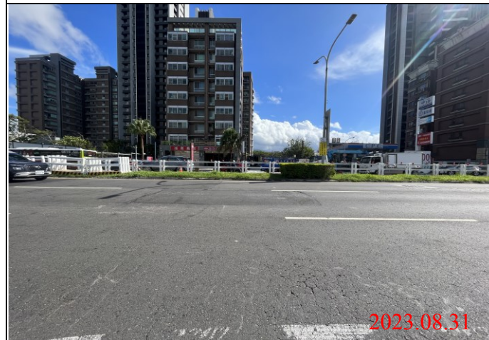
巡查日期地點：112.08.31/ Y23車站 照片說明：路面龜裂狀況
