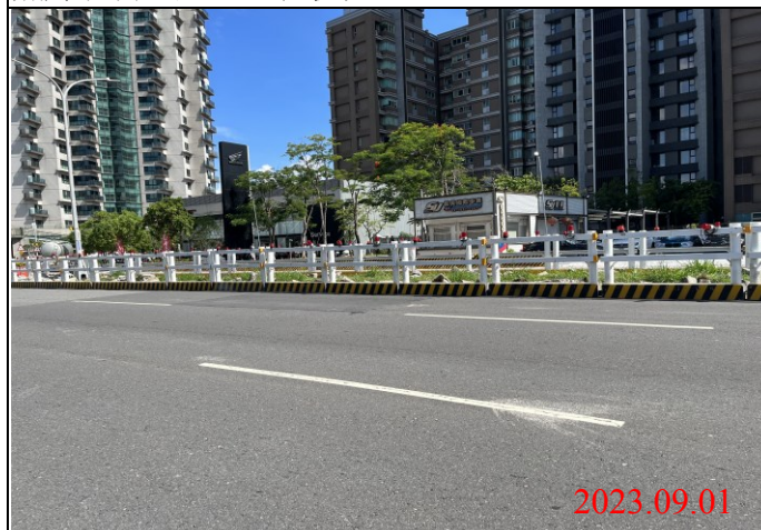
巡查日期地點：112.09.01/ Y23車站 照片說明：路面龜裂狀況
