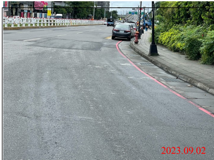
巡查日期地點：112.09.02/ Y23車站 照片說明：路面龜裂狀況
