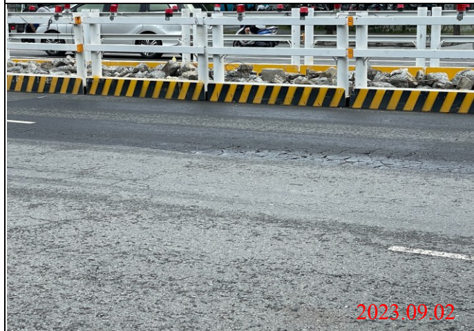
巡查日期地點：112.09.02/ Y23車站 照片說明：路面龜裂狀況
