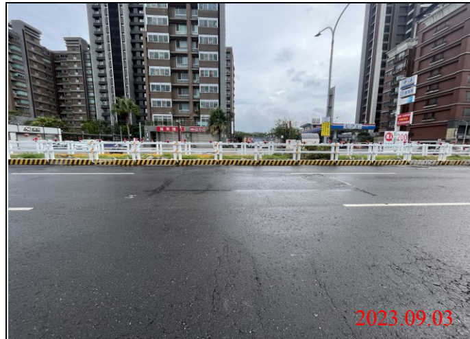
巡查日期地點：112.09.03/ Y23車站 照片說明：路面龜裂狀況
