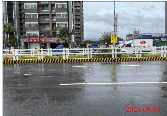
巡查日期地點：112.09.04/ Y23車站 照片說明：路面龜裂狀況
