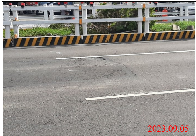
巡查日期地點：112.09.05/ Y23車站 照片說明：路面龜裂狀況
