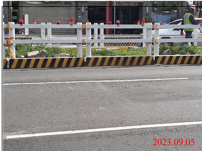
巡查日期地點：112.09.05/ Y23車站 照片說明：路面龜裂狀況
