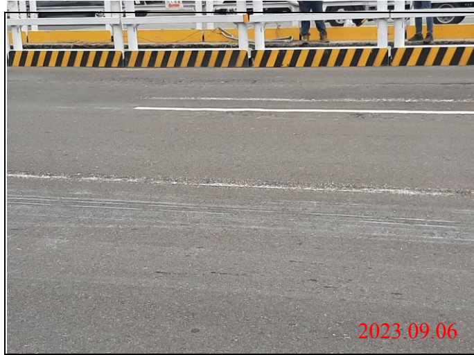
巡查日期地點：112.09.06/ Y23車站 照片說明：路面龜裂狀況
