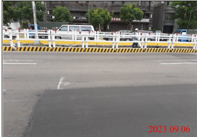
巡查日期地點：112.09.06/ Y23車站 照片說明：路面龜裂狀況
