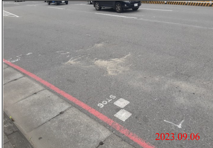
巡查日期地點：112.09.06/ X23車站 照片說明：路面龜裂狀況
