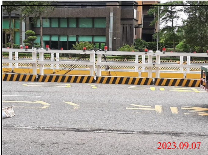
巡查日期地點：112.09.07/ Y23車站 照片說明：路面龜裂狀況
