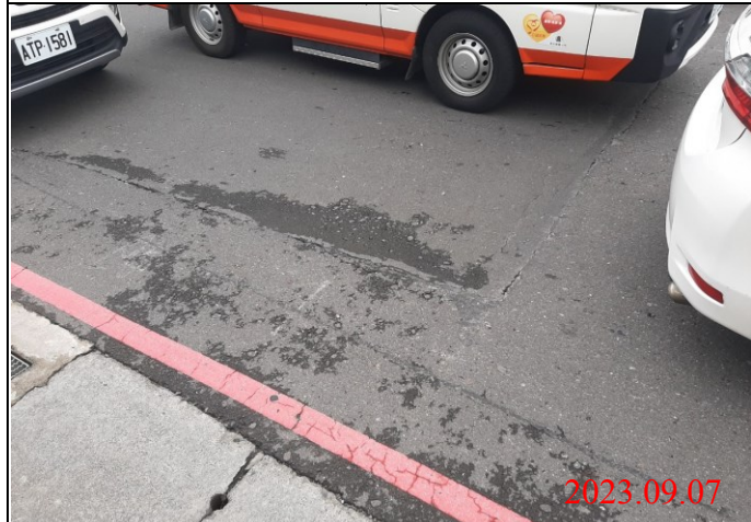
巡查日期地點：112.09.07/ Y23車站 照片說明：路面龜裂狀況
