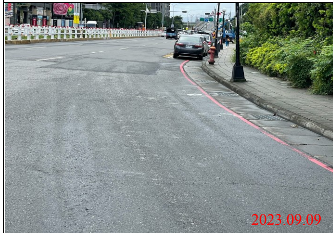
巡查日期地點：112.09.09/ Y23車站 照片說明：路面龜裂狀況
