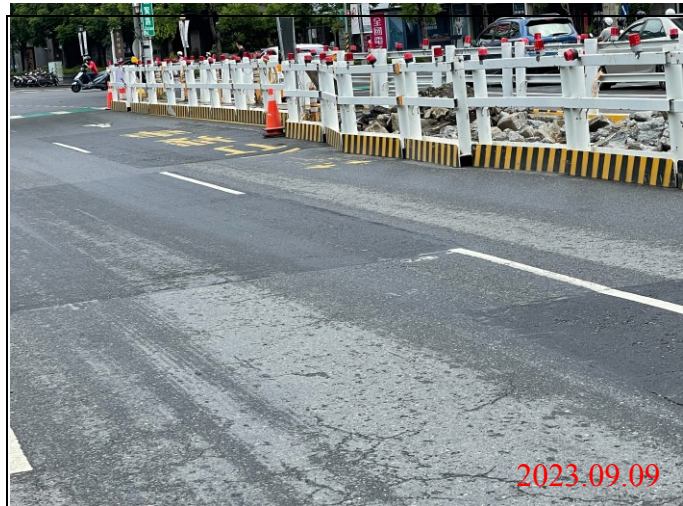
巡查日期地點：112.09.09/ Y23車站 照片說明：路面龜裂狀況
