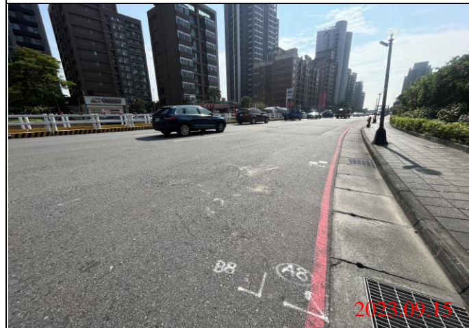
巡查日期地點：112.09.15/ Y23車站 照片說明：路面龜裂狀況
