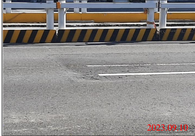
巡查日期地點：112.09.10/ Y23車站 照片說明：路面龜裂狀況
