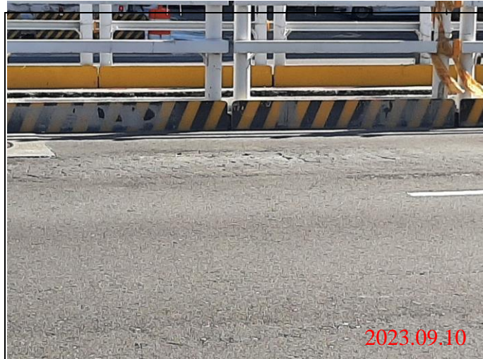
巡查日期地點：112.09.10/ Y23車站 照片說明：路面龜裂狀況
