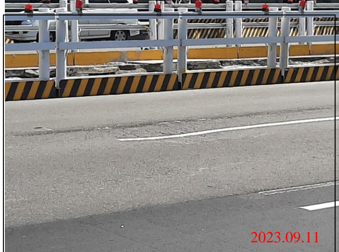
巡查日期地點：112.09.11/ Y23車站 照片說明：路面龜裂狀況
