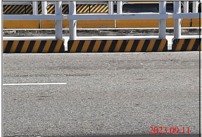
巡查日期地點：112.09.11/ Y23車站 照片說明：路面龜裂狀況
