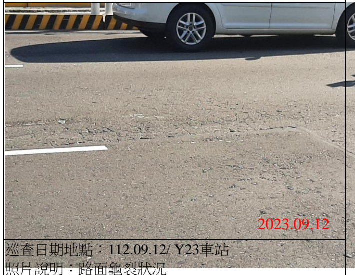
巡查日期地點：112.09.12/ Y23車站 照片說明：路面龜裂狀況
