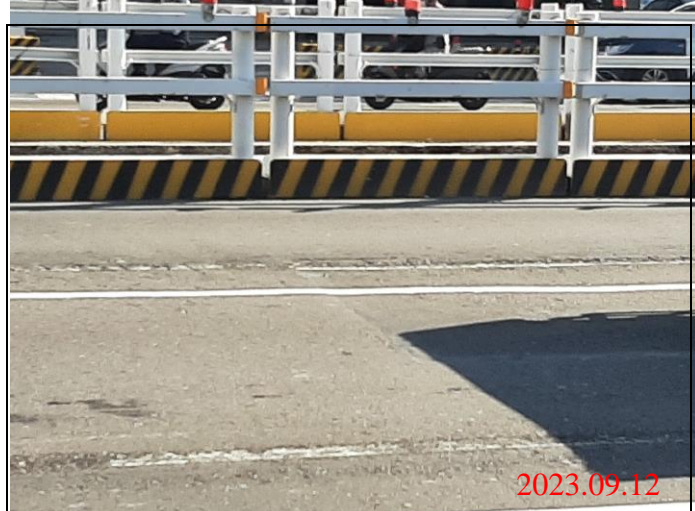
巡查日期地點：112.09.12/ Y23車站 照片說明：路面龜裂狀況
