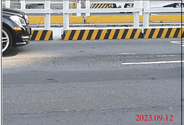
巡查日期地點：112.09.12/ Y23車站 照片說明：路面龜裂狀況
