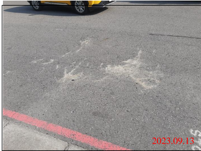
巡查日期地點：112.09.13/ Y23車站 照片說明：路面龜裂狀況
