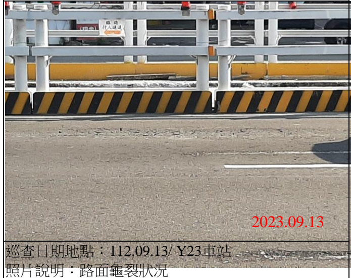
巡查日期地點：112.09.13/ Y23車站 照片說明：路面龜裂狀況
