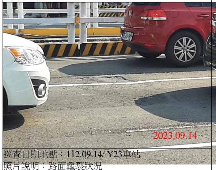
巡查日期地點：112.09.14/ Y23車站 照片說明：路面龜裂狀況
