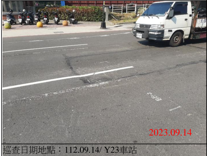
巡查日期地點：112.09.14/ Y23車站 照片說明：路面龜裂狀況
