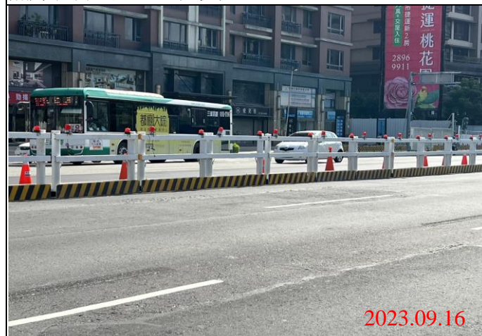
巡查日期地點：112.09.16/ Y23車站 照片說明：路面龜裂狀況
