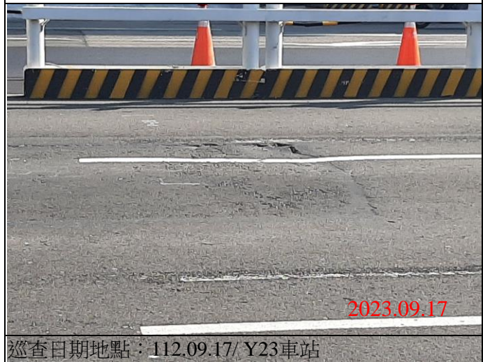
巡查日期地點：112.09.17/ Y23車站 照片說明：路面龜裂狀況
