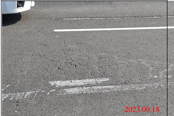
巡查日期地點：112.09.18/ Y23車站 照片說明：路面龜裂狀況
