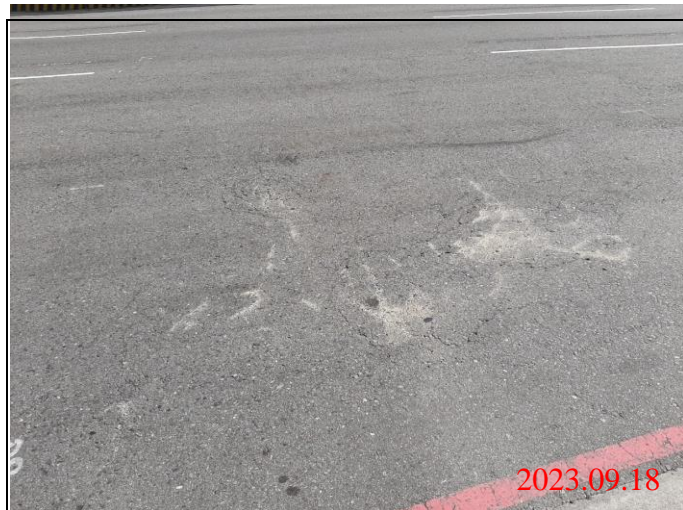
巡查日期地點：112.09.18/ Y23車站 照片說明：路面龜裂狀況
