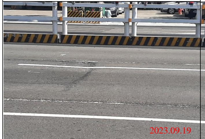
巡查日期地點：112.09.19/ Y23車站 照片說明：路面龜裂狀況
