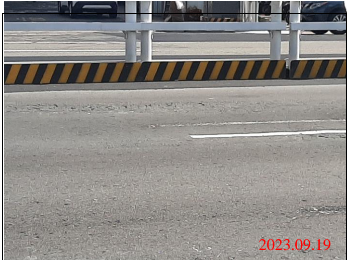
巡查日期地點：112.09.19/ Y23車站 照片說明：路面龜裂狀況
