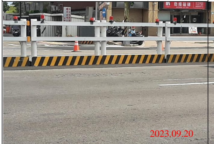
巡查日期地點：112.09.20/ Y23車站 照片說明：路面龜裂狀況
