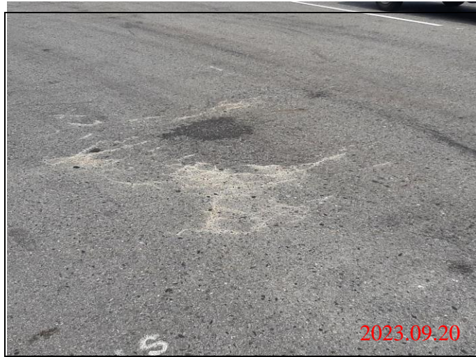
巡查日期地點：112.09.20/ Y23車站 照片說明：路面龜裂狀況
