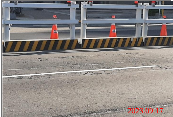
巡查日期地點：112.09.17/ Y23車站 照片說明：路面龜裂狀況
