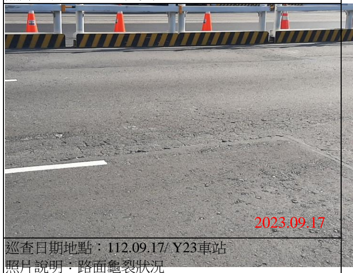
巡查日期地點：112.09.17/ Y23車站 照片說明：路面龜裂狀況
