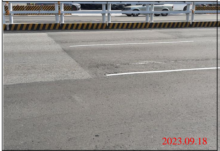
巡查日期地點：112.09.18/ Y23車站 照片說明：路面龜裂狀況
