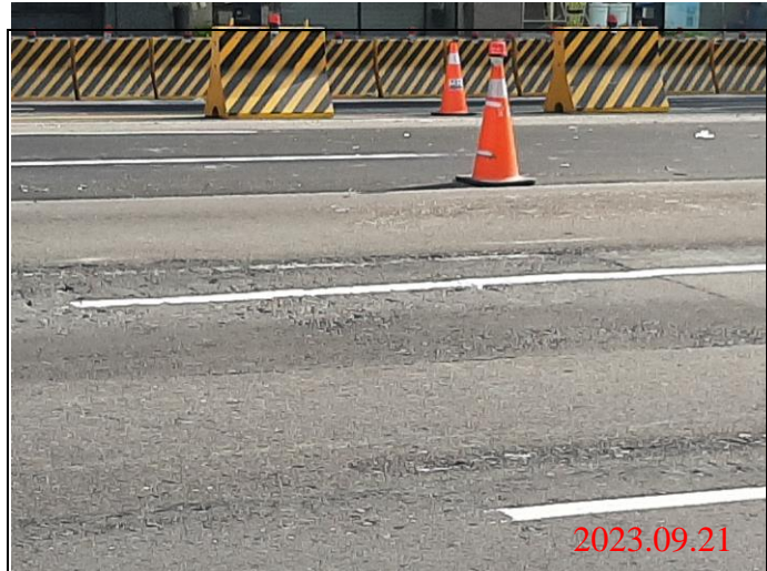
巡查日期地點：112.09.21/ Y23車站 照片說明：路面龜裂狀況
