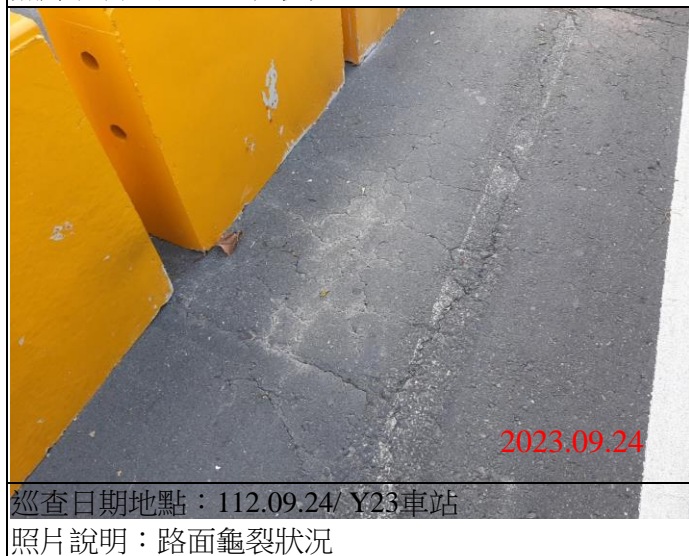
巡查日期地點：112.09.24/ Y23車站 照片說明：路面龜裂狀況
