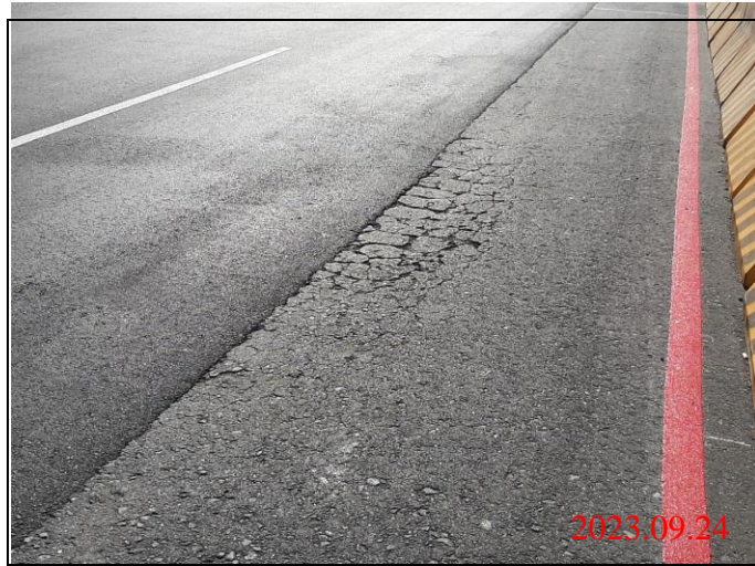
巡查日期地點：112.09.24/ Y23車站 照片說明：路面龜裂狀況
