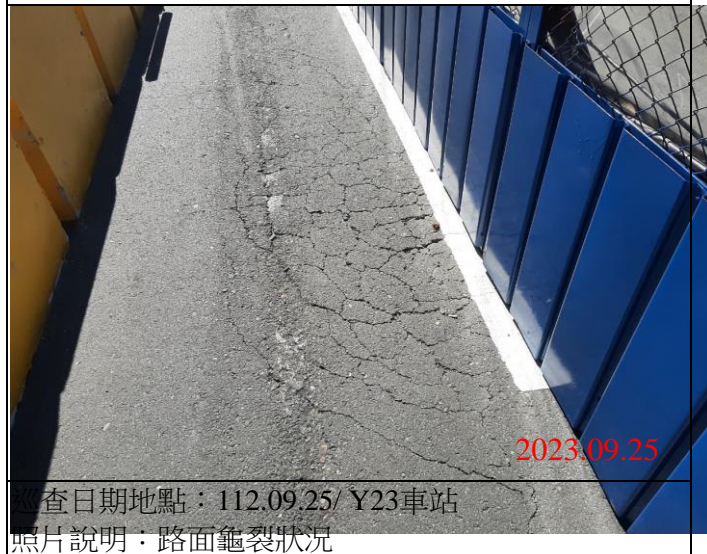
巡查日期地點：112.09.25/ Y23車站 照片說明：路面龜裂狀況
