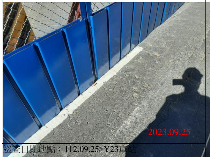
巡查日期地點：112.09.25/ Y23車站 照片說明：路面龜裂狀況
