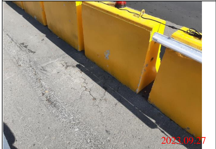
巡查日期地點：112.09.27/ Y23車站 照片說明：路面龜裂狀況
