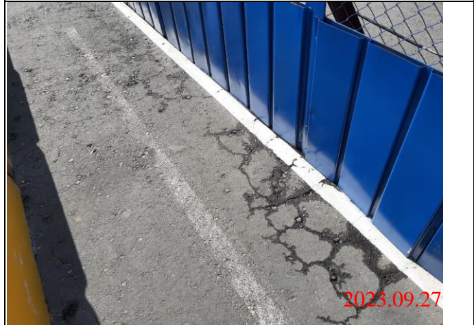
巡查日期地點：112.09.27/ Y23車站 照片說明：路面龜裂狀況
