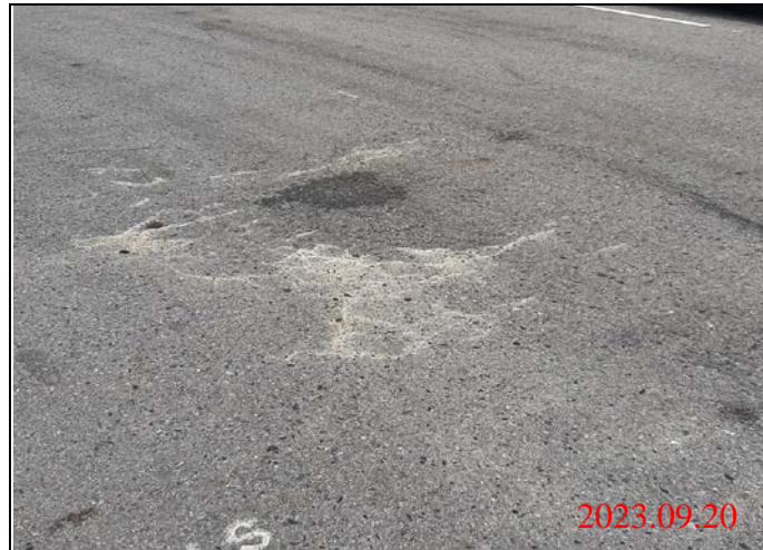
巡查日期地點：112.09.20/ Y23車站 照片說明：路面龜裂狀況
