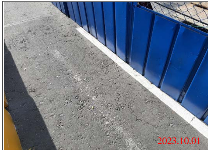
巡查日期地點：112.10.01/ Y23車站 照片說明：路面龜裂狀況
