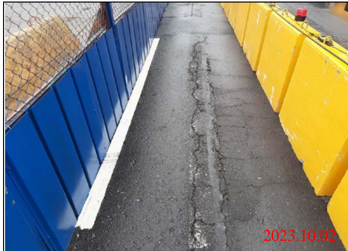
巡查日期地點：112.10.02/ Y23車站 照片說明：路面龜裂狀況
