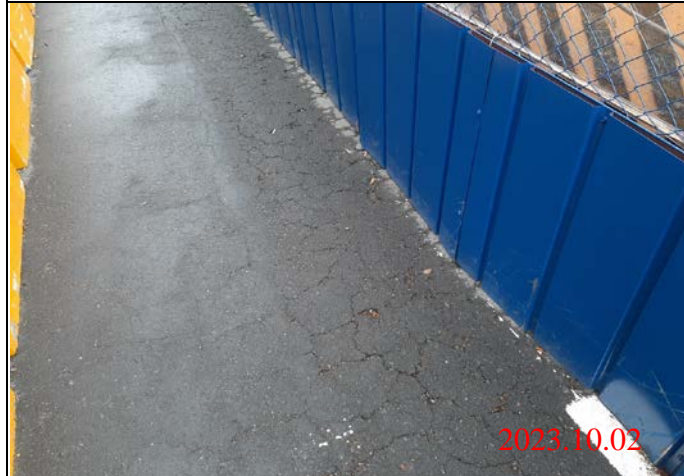
巡查日期地點：112.10.02/ Y23車站 照片說明：路面龜裂狀況
