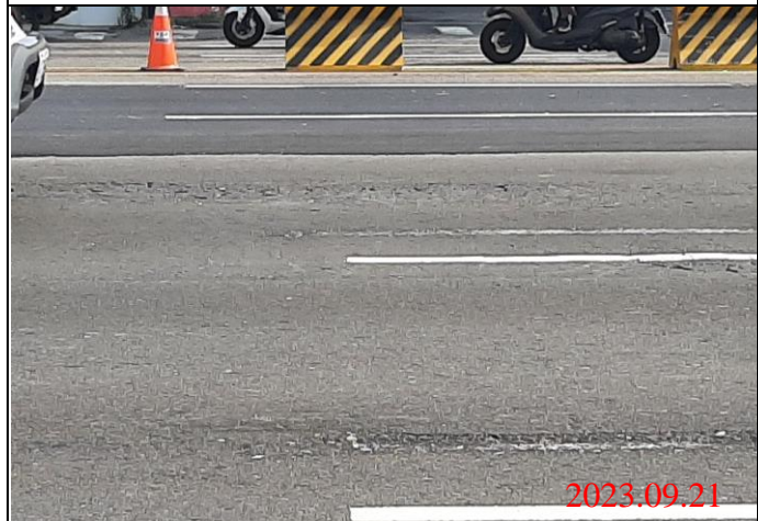
巡查日期地點：112.09.21/ Y23車站 照片說明：路面龜裂狀況
