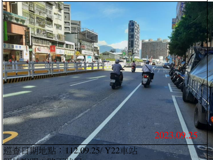
巡查日期地點：112.09.25/ Y22車站 照片說明：路面狀況
