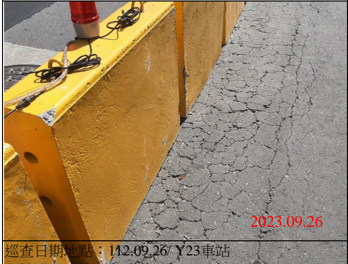
巡查日期地點：112.09.26/ Y23車站 照片說明：路面龜裂狀況
