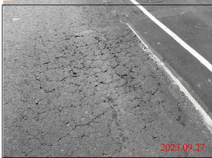
巡查日期地點：112.09.27/ Y23車站 照片說明：路面龜裂狀況
