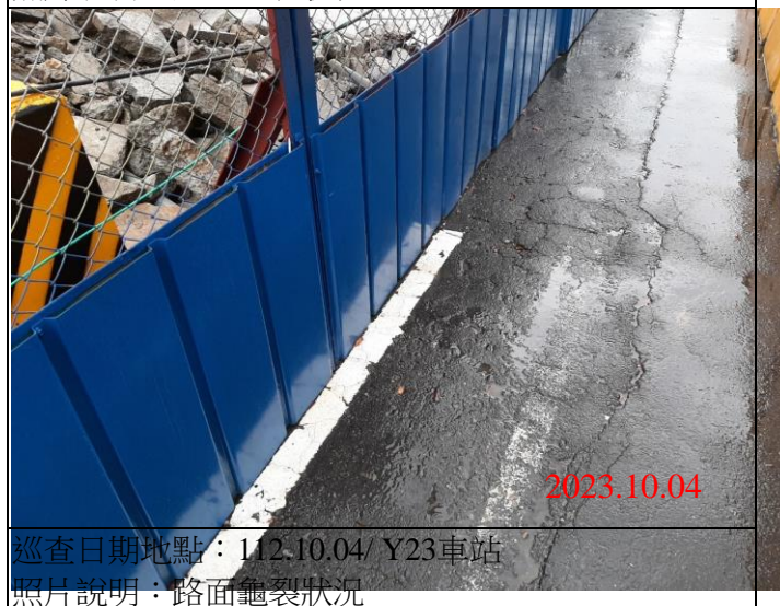
巡查日期地點：112.10.04/ Y23車站 照片說明：路面龜裂狀況
