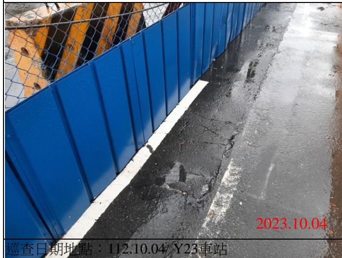
巡查日期地點：112.10.04/ Y23車站 照片說明：路面龜裂狀況
