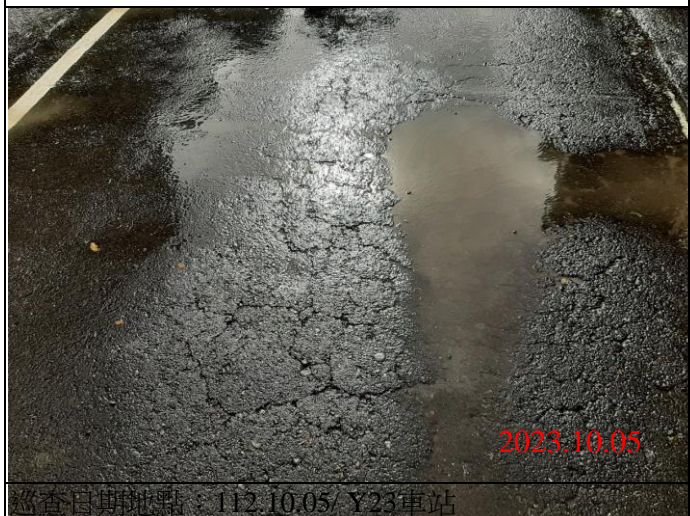
巡查日期地點：112.10.05/ Y23車站 照片說明：路面龜裂狀況
